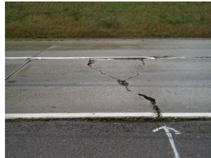
(d) Multiple cracks.
