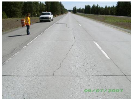
a. Longitudinal cracking
